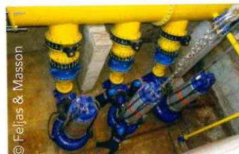
ALGERIE - Station de Pompage d'AIN SKHOUNA
