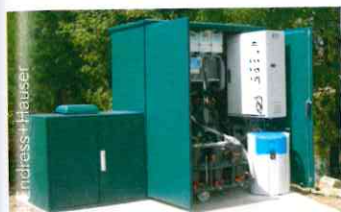
Station de mesure Endress+Hauser
